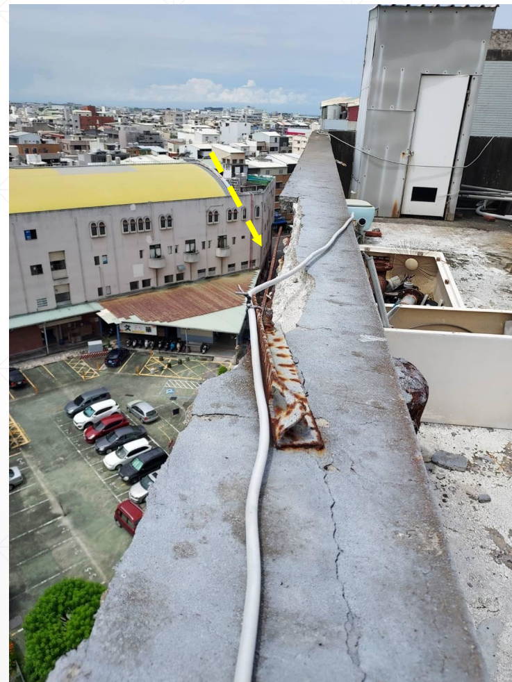
▲ 女兒牆混凝土飾條脫落
