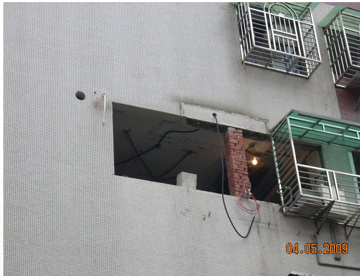
外牆擅自開口
