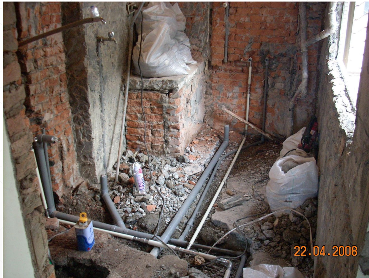
樓板埋管破壞結構層
