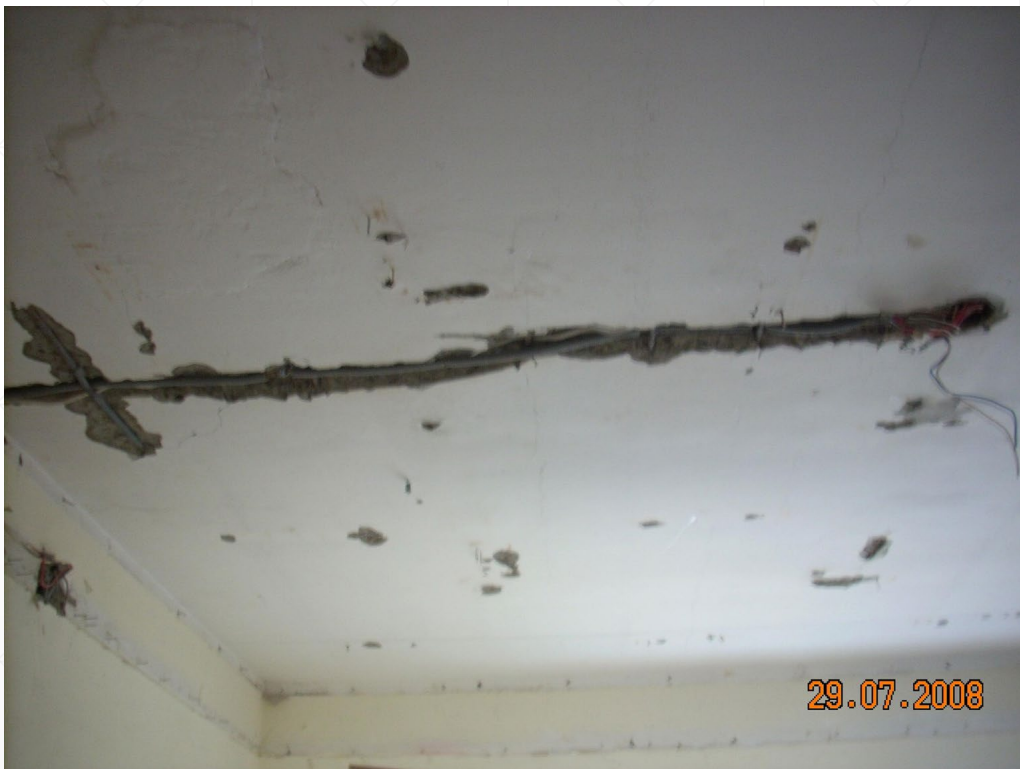
天花板埋管破壞結構層
