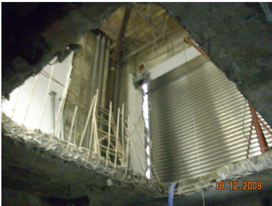
樓板擅自打除
