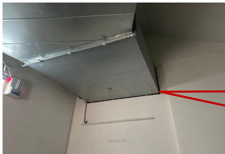
空調風管 貫穿防火區劃防火牆
