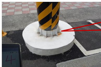
廣告燈塔 未配置接地線
