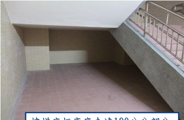
樓梯底板高度未達190公分部分 應設防護設施
