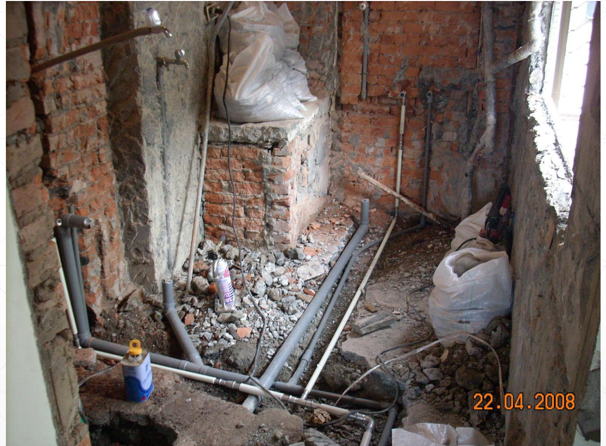
樓板埋管破壞結構層
