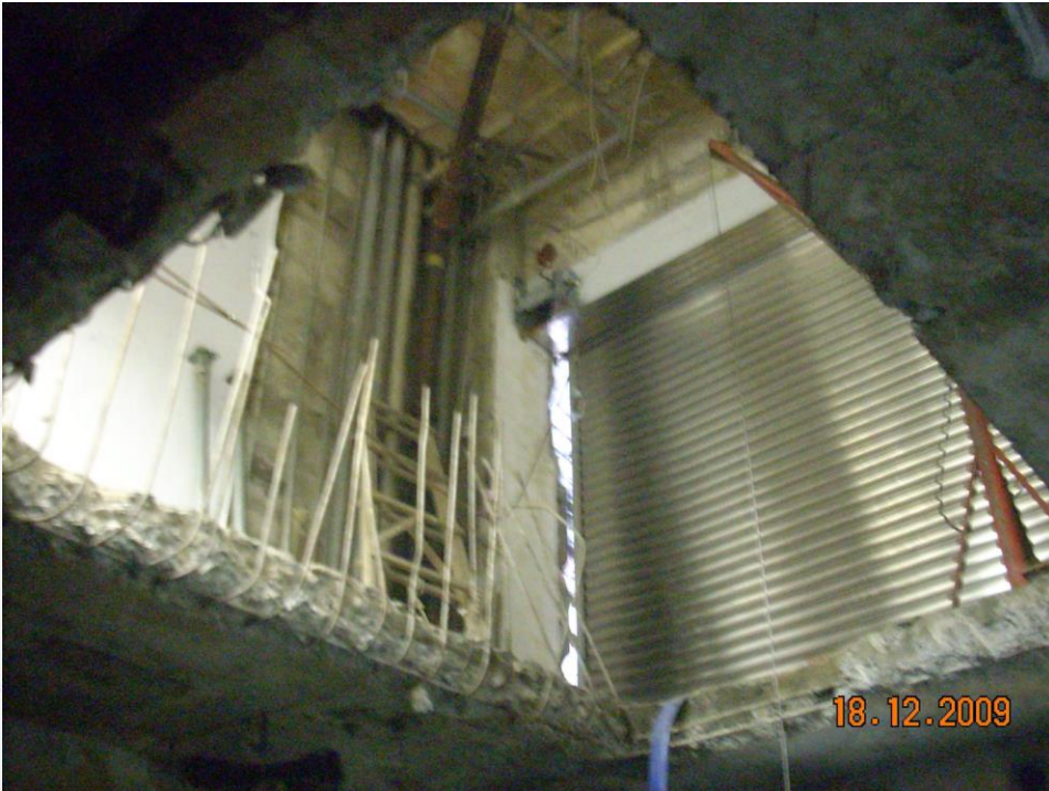
樓板擅自打除
