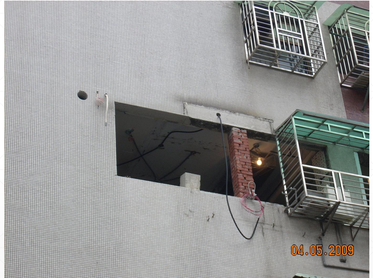
外牆擅自開口
