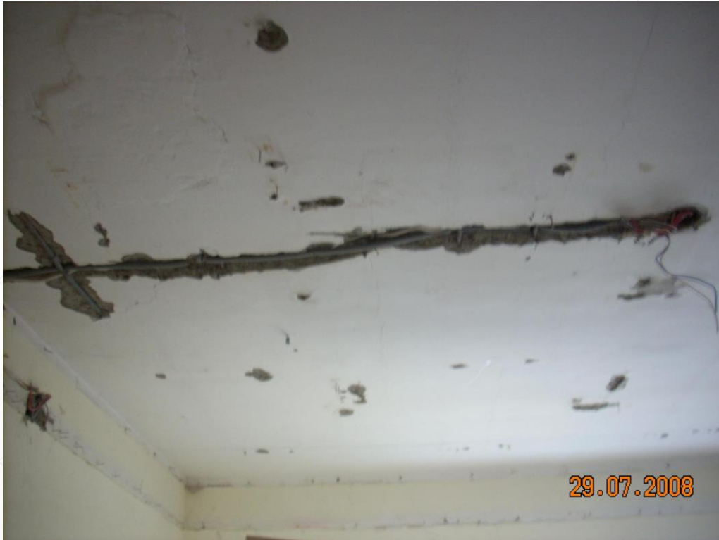
天花板埋管破壞結構層
