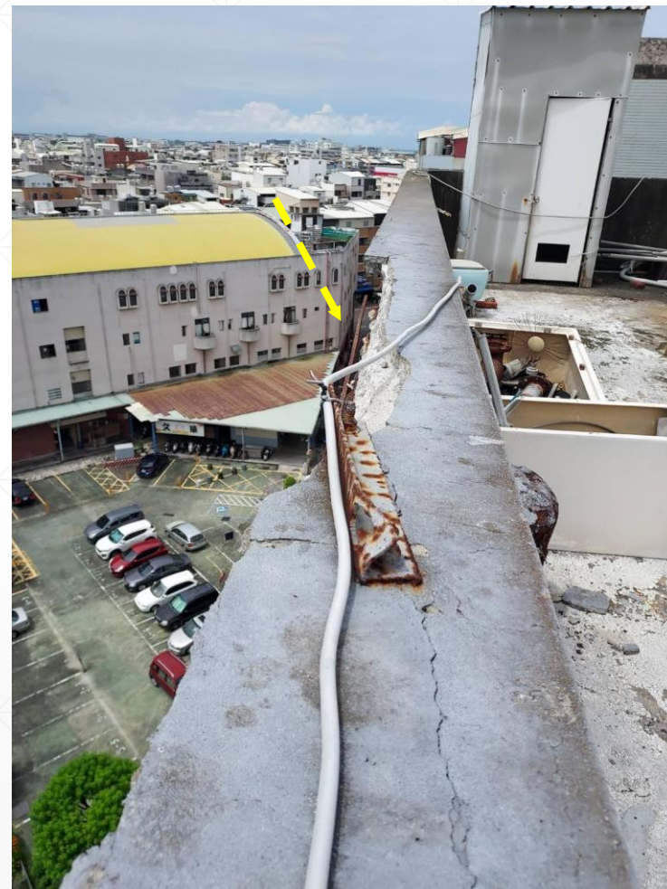
▲ 女兒牆混凝土飾條脫落
