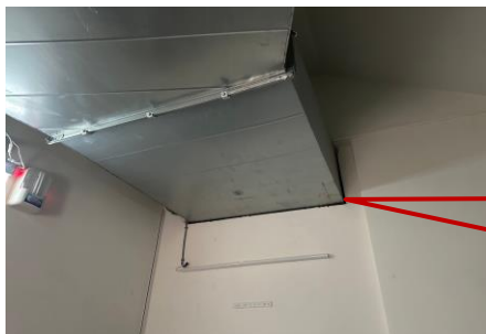
空調風管 貫穿防火區劃防火牆
