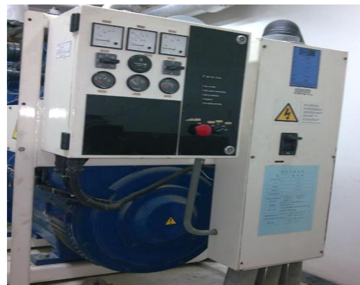
發電機操作控制箱/電力輸出總開關箱
