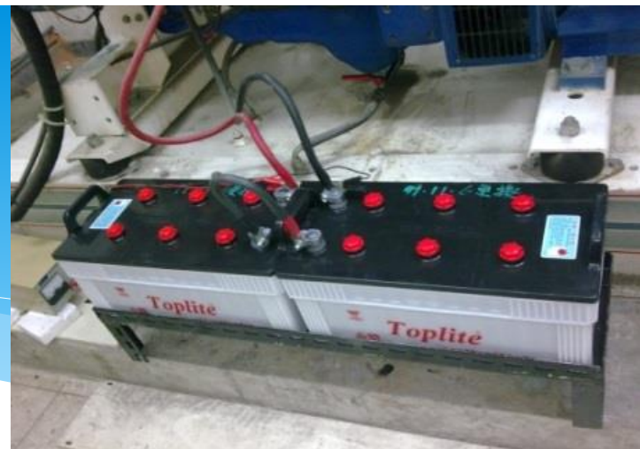
發電機蓄電池
