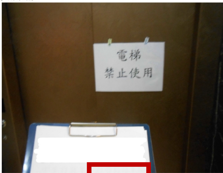
已停用昇降設備
