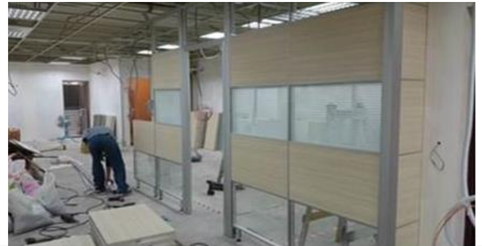
內部隔間牆變動、設置固定屏風均要申請室內裝修
