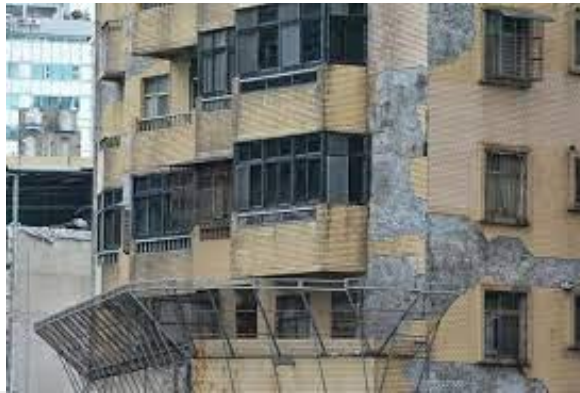
外牆飾面材料剝落
