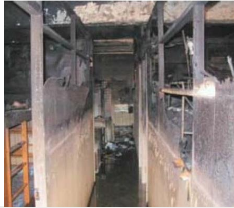
未申請室內裝修使用易燃材料
