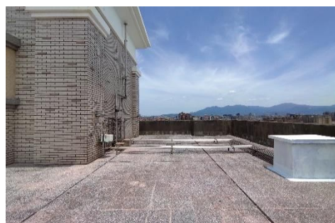
屋頂避難平台
