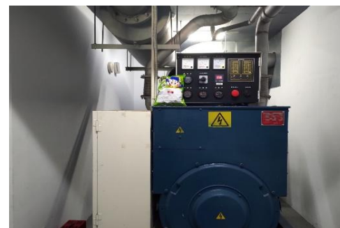
○ 緊急供電系統
